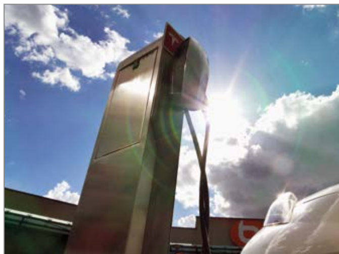
Une borne de la zone des Portes de Soissons à Vauxbuin
